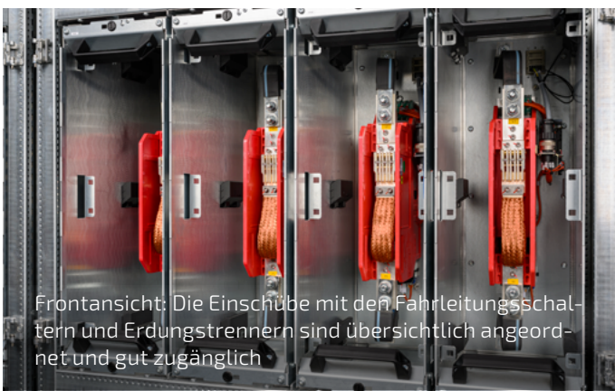
Die Anlage wird vorgängig inhouse vollumfänglich getestet
